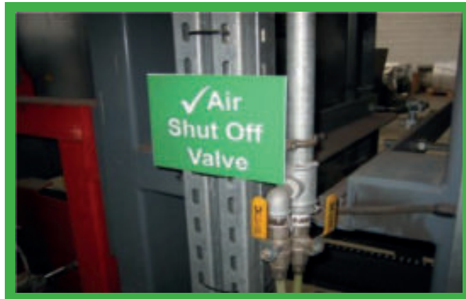
Duidelijk aangeduid pneumatisch isolatiepunt.
