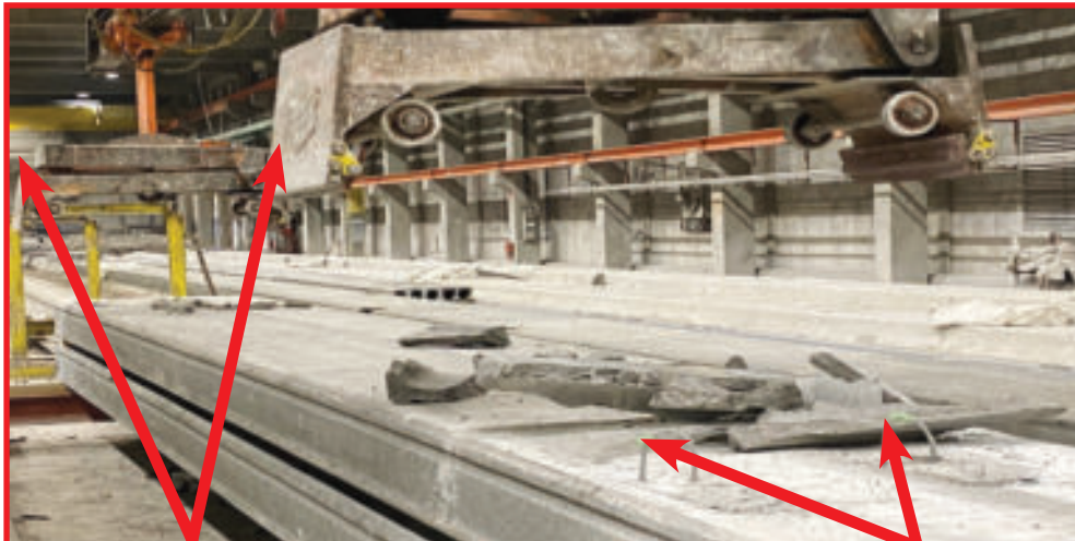
De kanaalplaat wordt op zijn plaats gehouden met behulp van de klemmen/grijpers van een bovenloopkraan.
