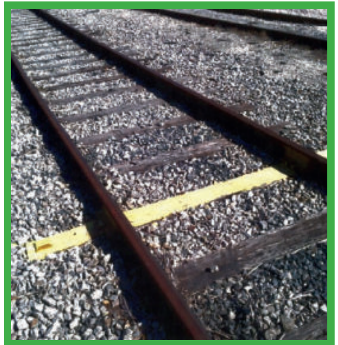
Markeringen die duidelijk aangeven waar geparkeerde wagons moeten staan.
