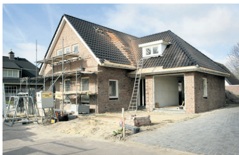
Bouwbedrijf Moes is succesvol overgestapt naar het gebruik van kalkzandsteenelementen bij de bouw van vrije sector woningen.
