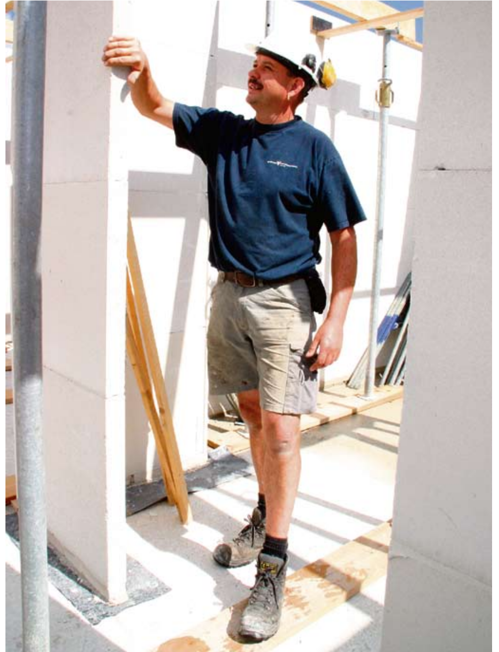
Leidinggevend voorman Jaap Tijmensens van Aannemingsbedrijf van de Vijzel BV is tevreden over de nieuwe 70 mm kalkzandsteen separatiewand: 'Je haalt een hoge bouwsnelheid en de binnenwanden zijn erg sterk.'
